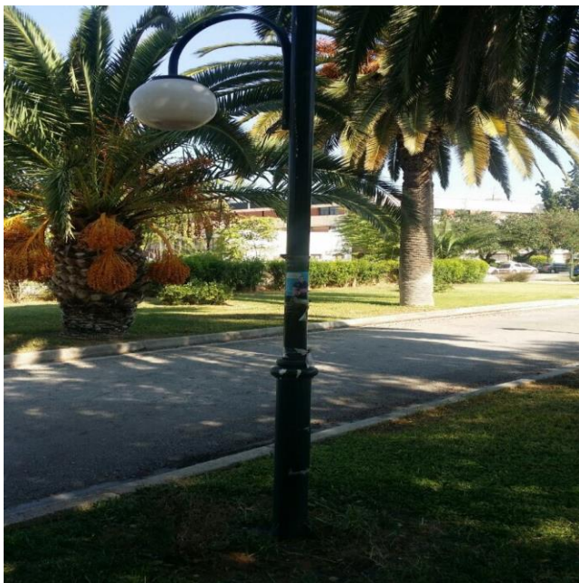
Φωτό 1: Εξωτερικό φωτιστικό δρόμου φοινίκων
